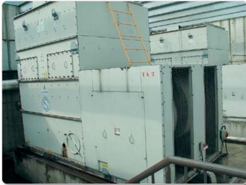
Рисунок 4. Градирни для охлаждения воды контура тепловых насосов
